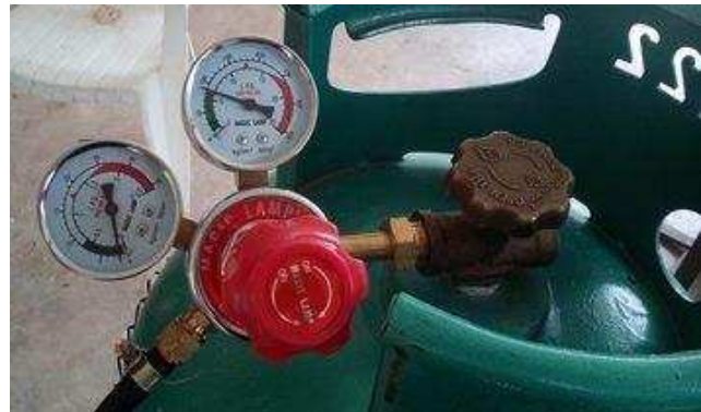
อุปกรณ์ควบคุมการจ่ายแก๊ส
