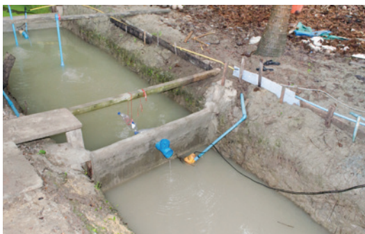
จ) บ่อที่ 5 พักน้ำที่บำบัดแล้วรอปล่อยทิ้งหรือนำกลับมาใช้ซ้ำ
